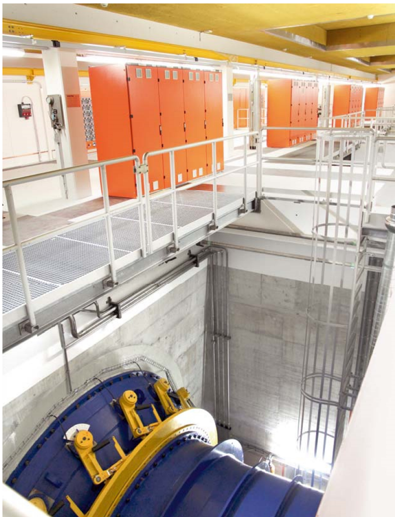
Vue de l'intérieur de la centrale au fil de l'eau d'Axpo à Aarau.
