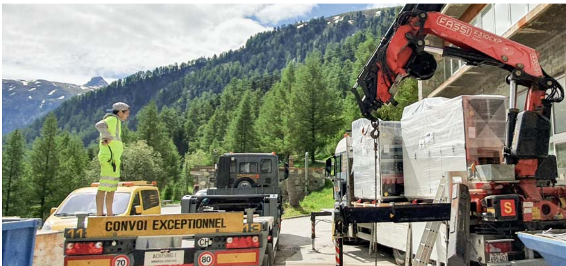
— Le nouveau convertisseur de fréquence a été livré à la station de pompage alpine fin mai.
